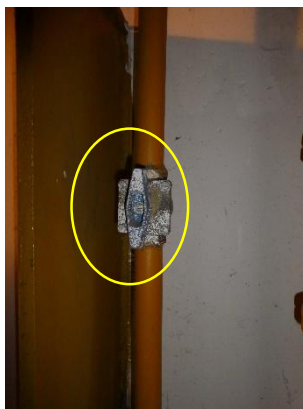
5. kép: A lépcsőházankénti gáz főelzáró csap
